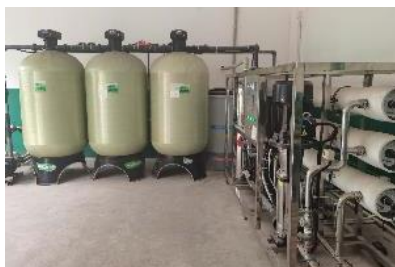
神基越南 純水機設備
